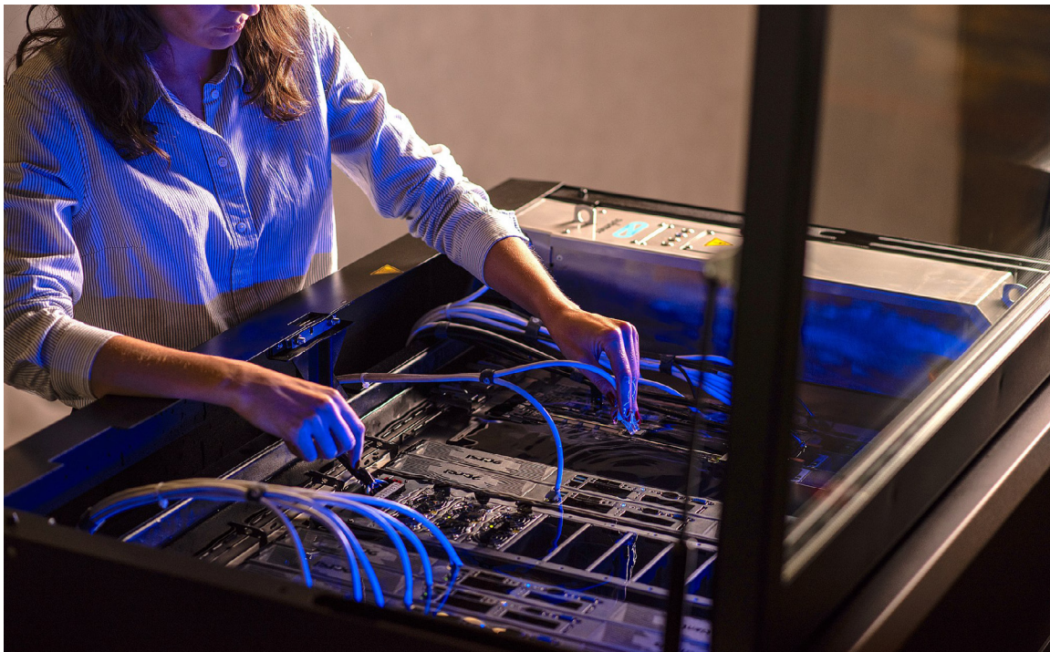
Submer Immersion Cooling, CC BY-SA 4.0 , via Wikimedia Commons
